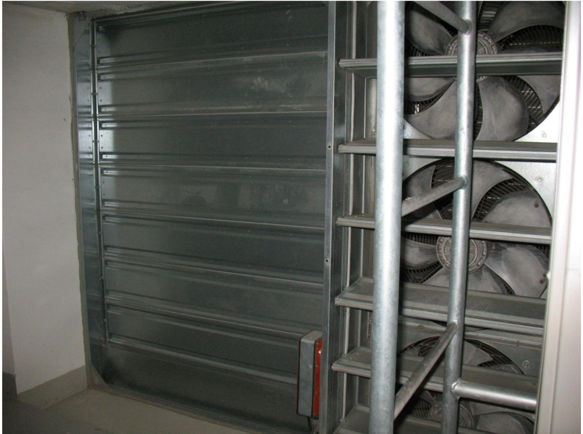
Kuva 2. Lämmityspatterin sulkupellit ja avustavat puhaltimet.
