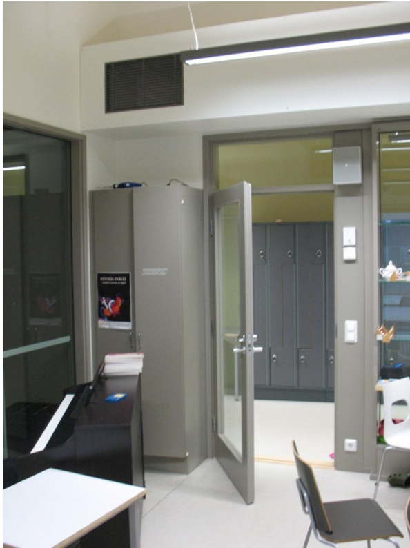
Kuva 5. TSI Velocicalc -mittarin sijoitus. Kuvassa näkyy myös ovipielen lämpötila- ja hiilidioksidiantureiden sijainti sekä siirtoilmasäleikkö aulaan.
