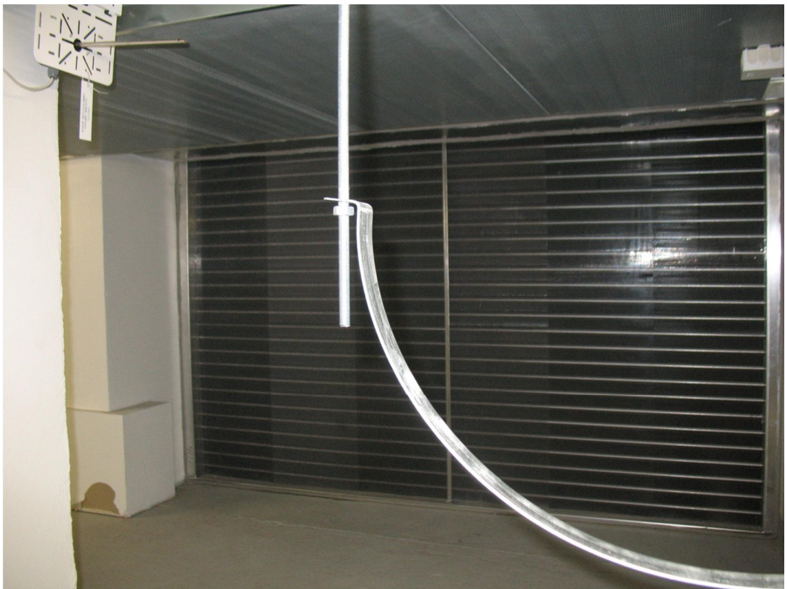
Kuva 8. Moottoriventtiiliä ohjaava lämpötila-anturi ja lämmityspatteri.
