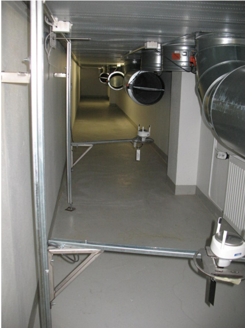
Kuva 3. Tuloilmakäytävä ja tilakohtaiset tuloilmakanavat. Kuvassa näkyvät myös virtausanturit.
