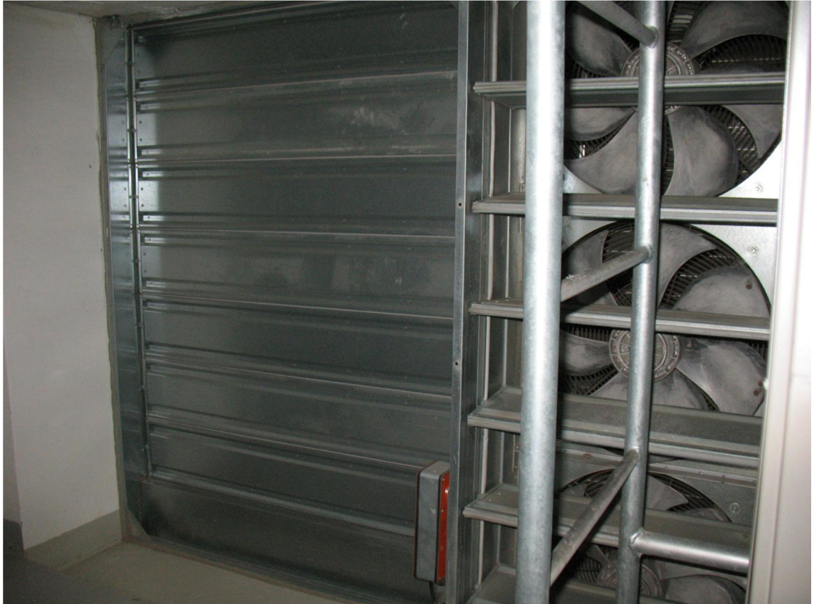
Kuva 7. Lämmityspatterin avustavat puhaltimet ja sulkupellit. Kuvassa avustavat puhaltimet ovat käynnissä ja sulkupelti vapaalla virtausalueella on kiinni.
